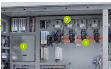
Innenraum der CellCube Großbatterie mit Flow Battery Controller
