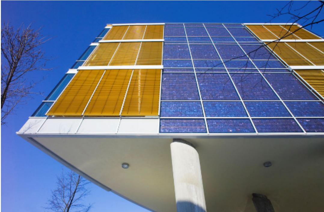
Fassadenintegrierte Photovoltaikmodule, die zusammen mit den SunCarrier Referenzanlagen in Summe den Strombedarf des Kompetenzzentrums sicher stellen.
