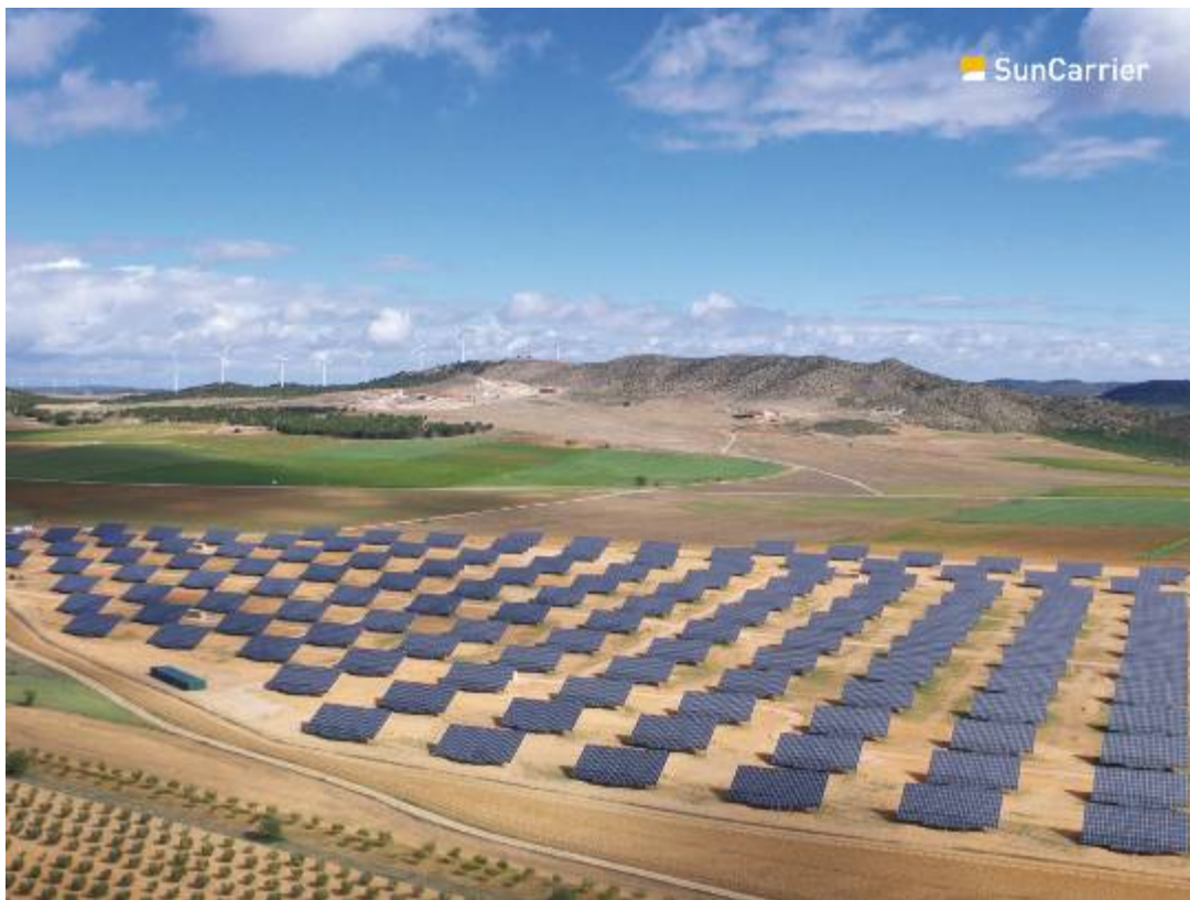
Solarpark im spanischen Pozohondo mit insgesamt 150 installierten SunCarrier 300 und einer Leistung von 5.150 kWp.
