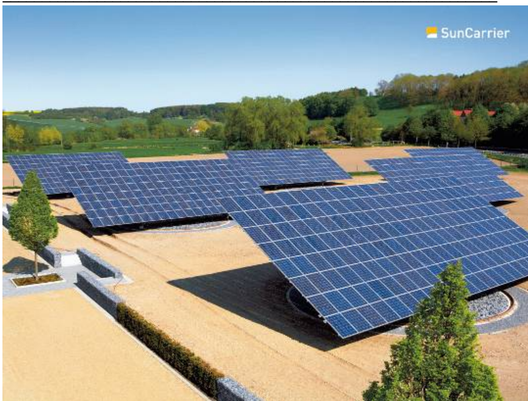
Sechs installierte SunCarrier 220 in Büren (Deutschland) mit einer Leistung von insgesamt 185 kWp.
